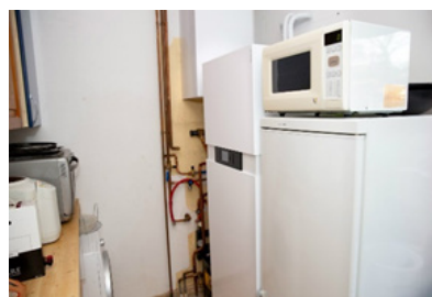
Volledige warmtepomp naast de koelkast en magnetron in de bijkeuken
