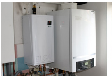
Hybride warmtepomp (links) met cv-ketel (rechts).
