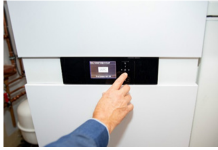
Bedieningspaneel van de warmtepomp.
