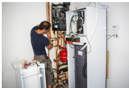
De cv-ketel wordt weggehaald, de warmtepomp staat klaar. Bovenin zit de techniek, onderin het voorraadvat.
