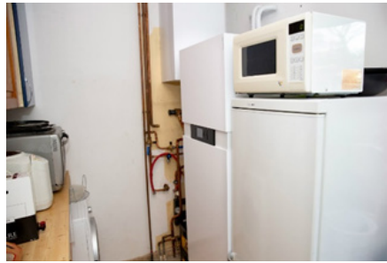
De warmtepomp is klaar voor gebruik. Hij staat in de bijkeuken naast de koelkast en magnetron.
